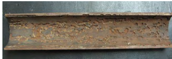
Рисунок 1. Пошкодження на внутрішній поверхні газової труби (Харківська обл., Підприємство «Укргазвидобування»)
